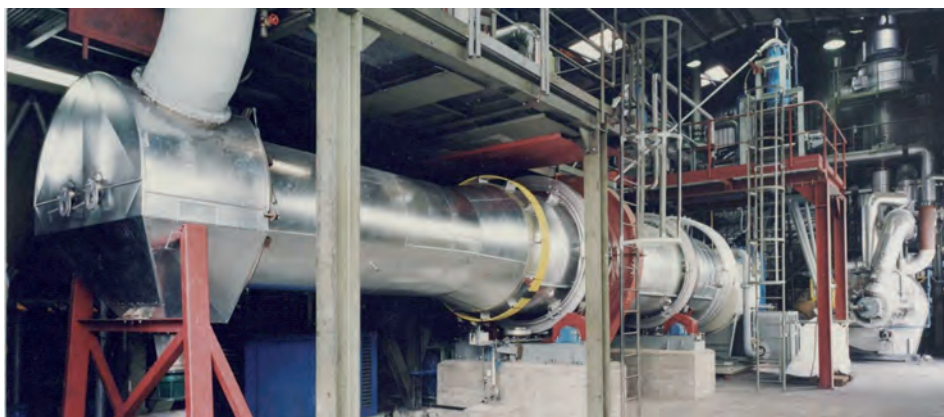
Bild 8: Reaktivierungsanlage in Frankfurt
