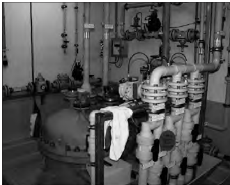
Bild 3 a: Kerzenfilter zur Abtrennung von Feststoffen (Kohlepartikel, Staub) aus der Abschlammung der nassen Abgasreinigung
