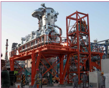
Bild 1: Typische Vakuumdestillationsanlage für Schlämme
