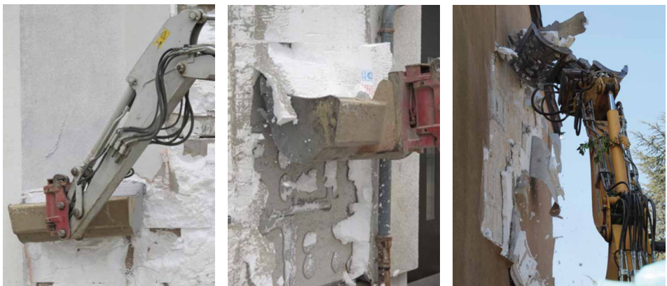
Bild 7: Selektives Abschälen der einzelnen Lagen im IBP-Versuch, Oberputz (links), Dämmstoff (Mitte) und teilselektives Abschälen in der Praxis (rechts)
