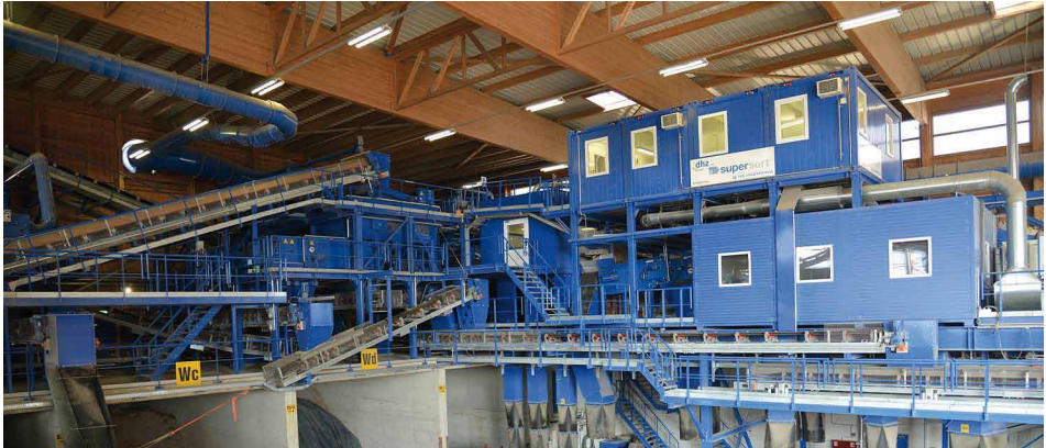
Bild 2: Auszug aus der ersten Verarbeitungsstufe der Aufbereitungsanlage
