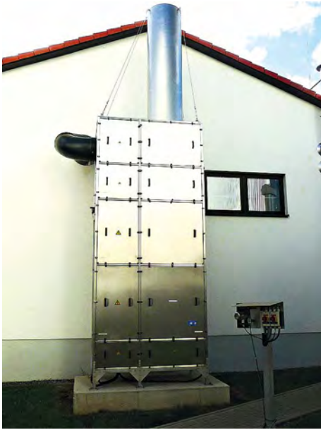
Bild 3: Abluftanlage für 5.100 m 3 /h Abluft aus der Lebensmittelindustrie
