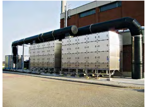
Bild 6: Abluftanlage Zentralkläranlage, Werkbild Neutralox Umwelttechnik GmbH
