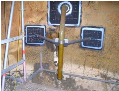
Bild 5: Nachgerüstete Oxidationsluftlanze bei MVV Umwelt Mannheim
