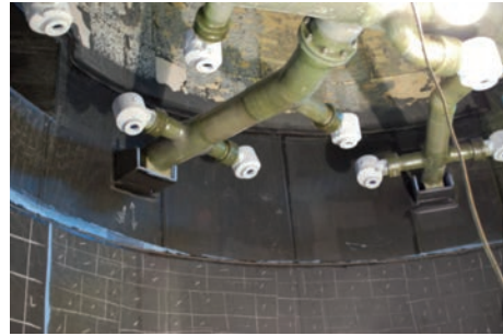
Bild 4: Die Sprühebene im Absorber bei MVV Umwelt Mannheim
