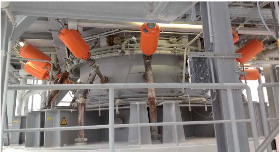
Bild 12: Luftkanonen im Bereich der Kühlluftabführung
