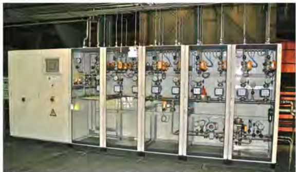
SNCR-Anlage in einem Kohlekraftwerk (225 MW el ), Polen
