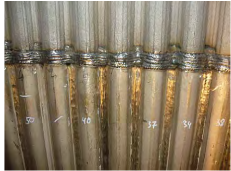
Bild 21: Panelstoß an Alt-Inconel
