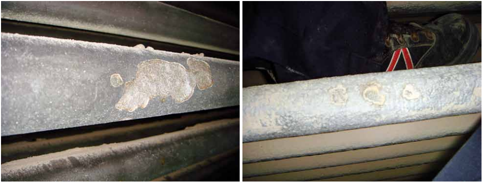
Bild 2: Punktuelle Schäden an thermisch gespritzten (links) und auftragsgeschweißten (rechts) Schutzschichten
