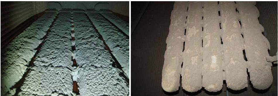
Bild 11: Verschmutzungszustand des Strahlungsüberhitzers
