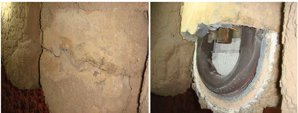
Bild 9: Gebrochene Bogenplatte (links), darunterliegendes Überhitzerrohr (rechts), keine Korrosionsspuren
