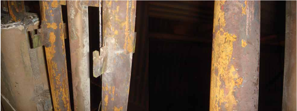
Bild 10: Überhitzerrohre im Bereich 420 °C (linke Bildhälfte) und 465 °C (rechte Bildhälfte)
