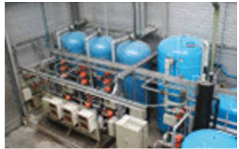
Bild 14: Sole-Reinigung: Sand- und Aktivkohlefilter sowie Ionenaustauscher
