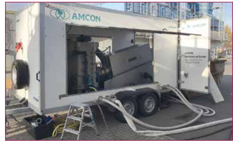
Bild 2: Anhänger mit einer installierten Schneckenpresse als mobile Entwässerungseinheit
