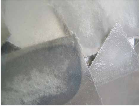
Bild 6: Detailansicht der Zinkauflösung an der Blechoberfläche
